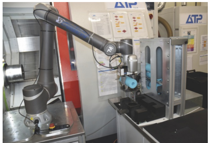
Vista del sistema d'automazione robotica di carico e scarico sviluppata e realizzata per ATP dal system integrator G. Engineering, sfruttando le potenzialità di un robot collaborativo Techman TM12, di cui il partner Sinta è distributore per l'Italia.
